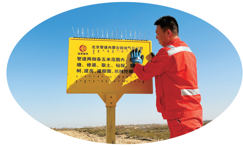
管道警示牌安装了不锈钢驱鸟铁丝网
