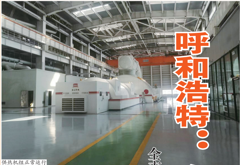
供热机组正常运行
