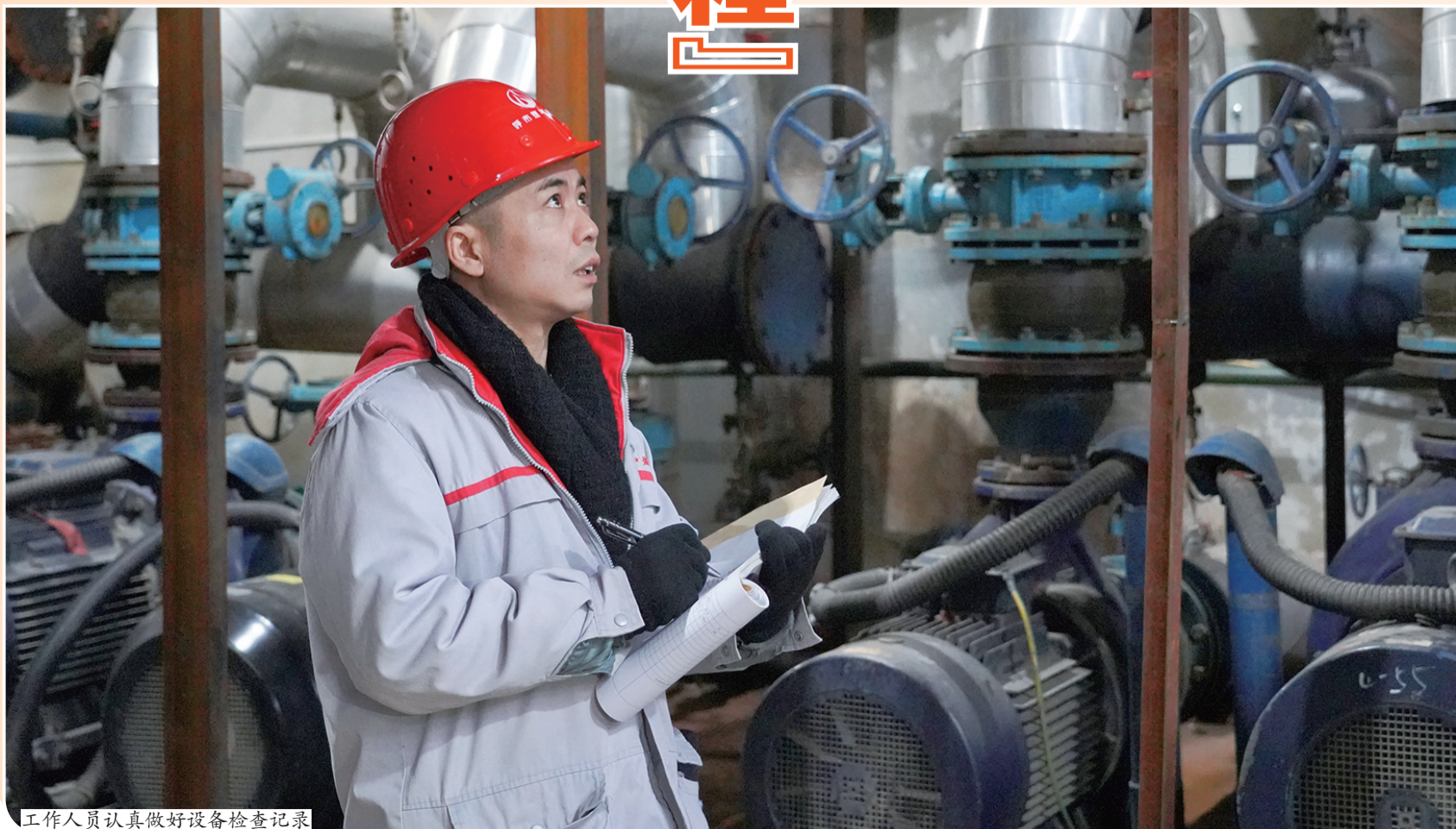
工作人员认真做好设备检查记录
