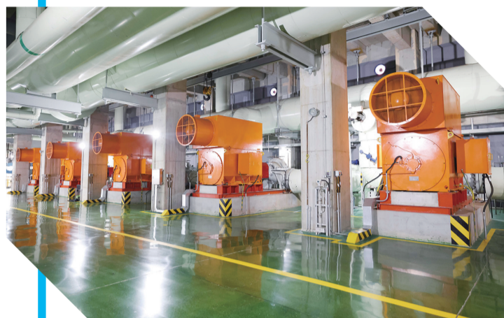
内蒙古能源集团温暖工程供热首站
