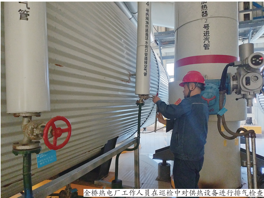
金桥热电厂工作人员在巡检中对供热设备进行排气检查
