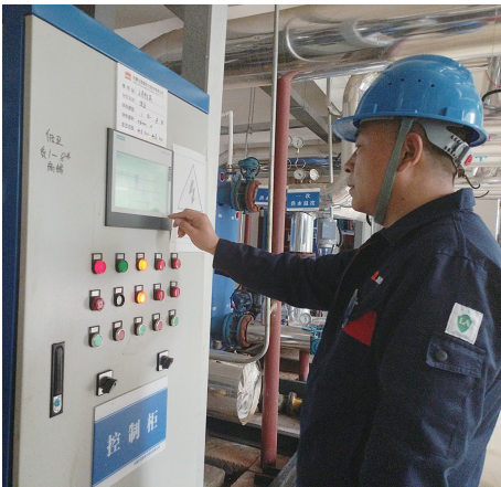
晟泰热力公司工作人员检查换热站供热运行情况
