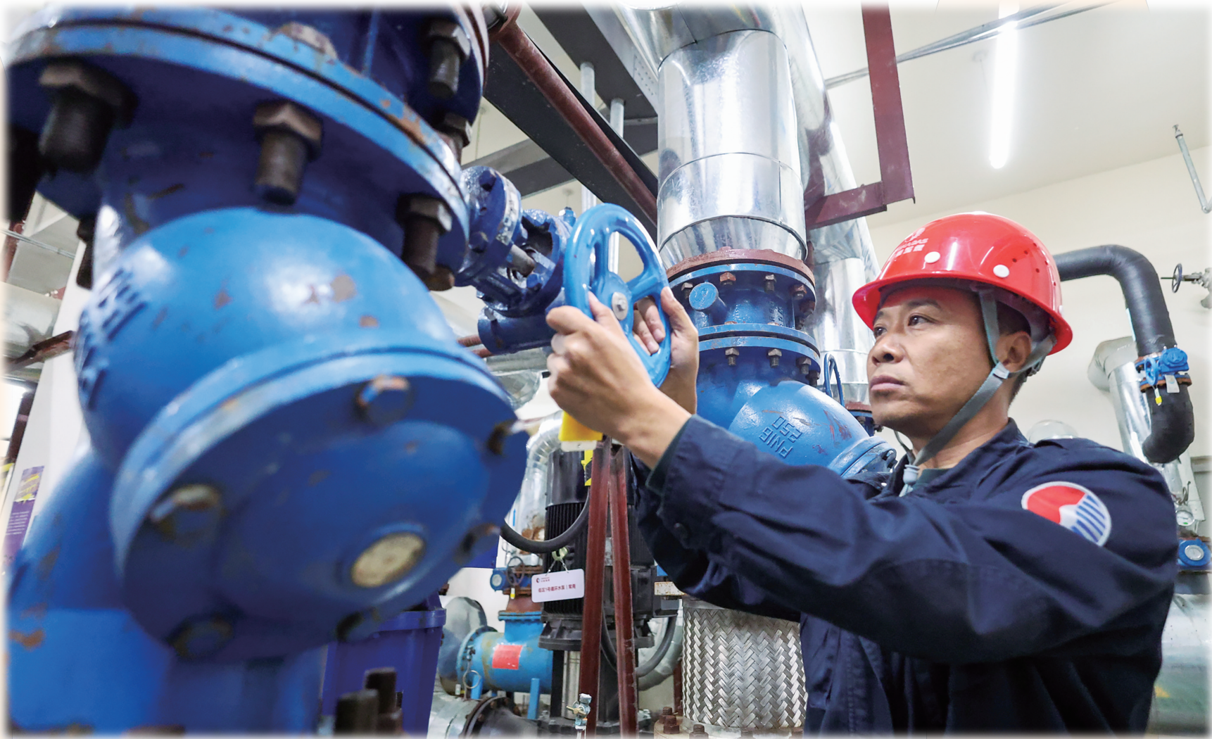
呼和浩特中燃供热分公司巡检员在信达小区燃气锅炉房开启管道阀门。
