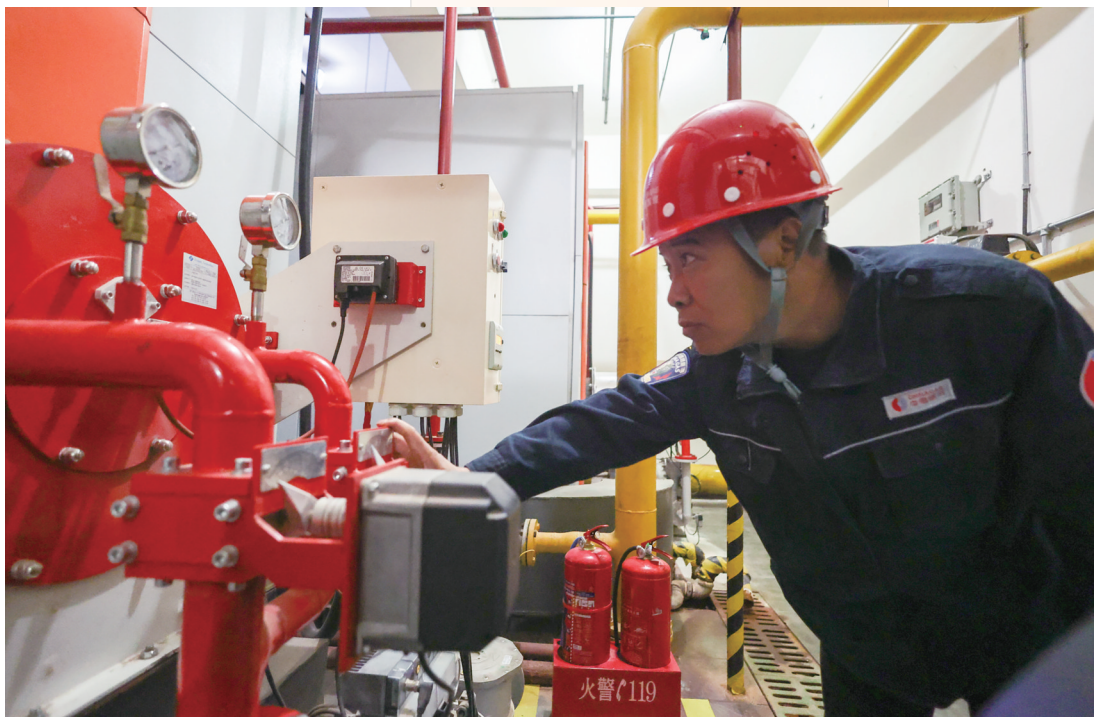
呼和浩特中燃供热分公司巡检员在信达小区燃气锅炉房,检查燃烧机头火焰。
