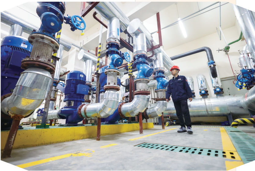
呼和浩特中燃供热分公司巡检员在信达小区燃气锅炉房巡检。
