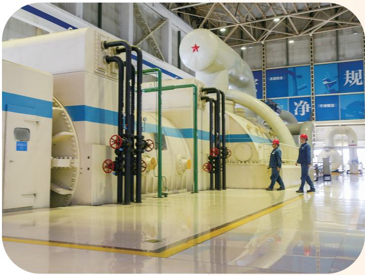
10月9日,华能北方公司金桥热电厂的工作人员正在巡检。
