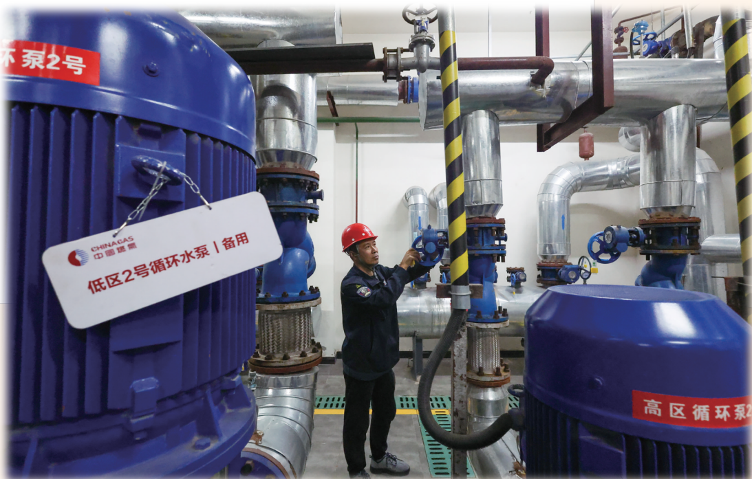
巡检员在燃气锅炉房检查循环泵阀门开启状态。
