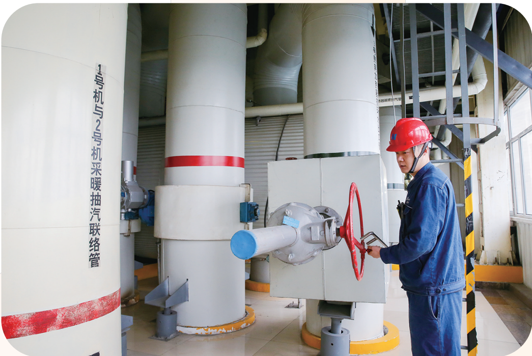
华能北方公司金桥热电厂的工作人员在检查设备。
