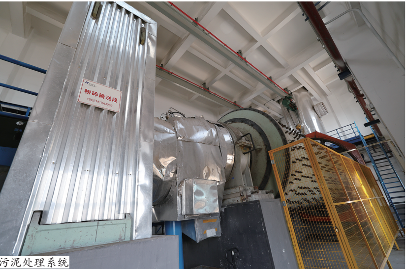
污泥处理系统
