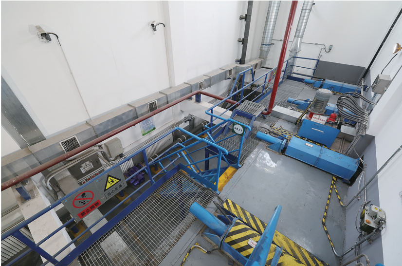
污泥输送系统
