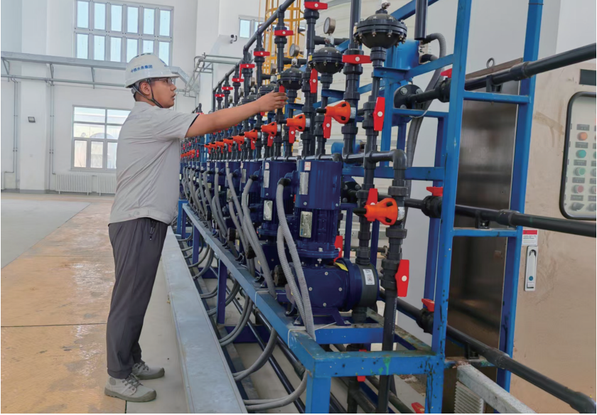
技术人员正在查看设备运行情况
