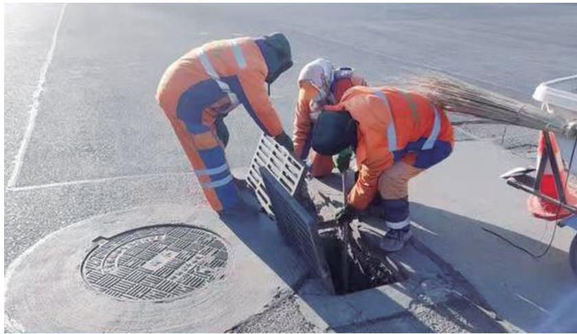
环卫工人正在清扫雨篦子
