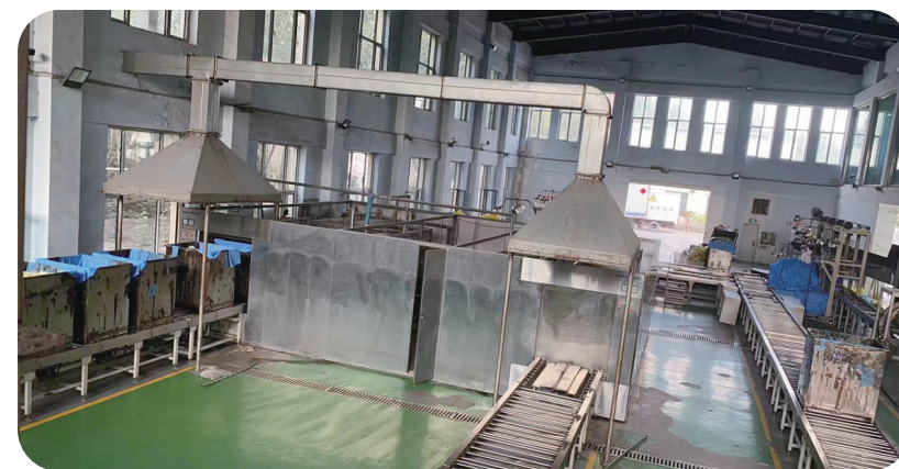
呼和浩特市奕德康医疗垃圾处理有限公司医疗垃圾处置车间
