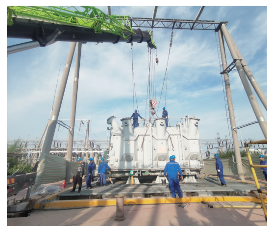
修前试验、引线拆除……近日,在位于托克托县工业园区的220千伏燕山营变电站内,呼和浩特供电公司变电管理二处工作人员正在对2号主变压器进行风冷改造。
