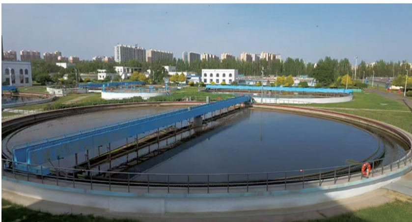
辛辛板污水处理厂沉淀池
