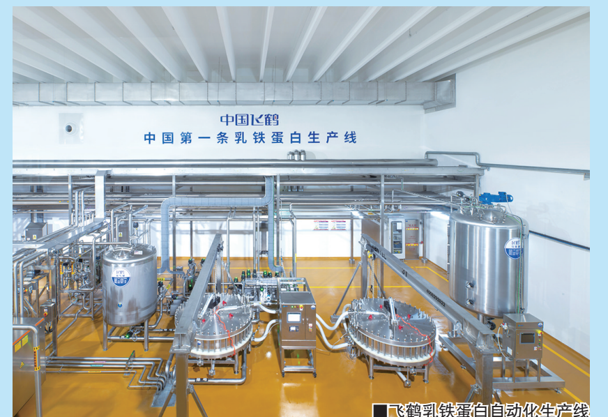
飞鹤乳铁蛋白自动化生产线
