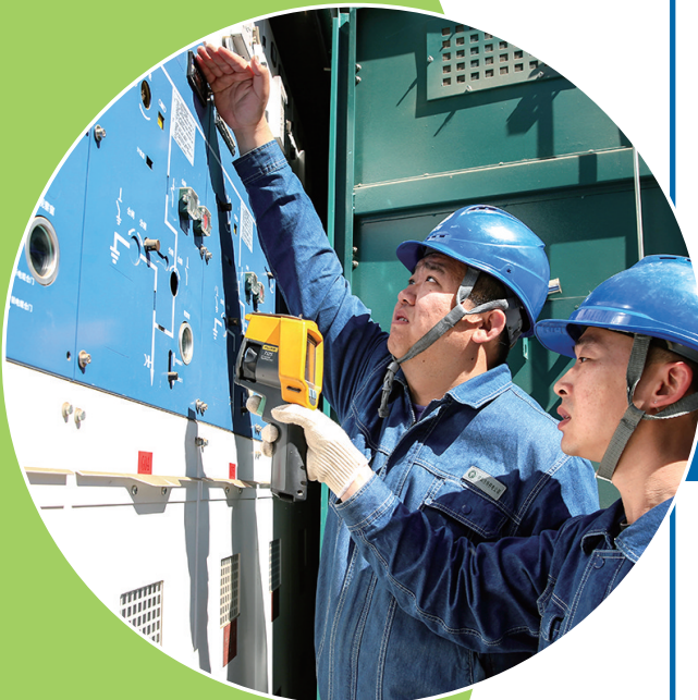
▲ 供电部门检测市招考中心、考点周边的电网柜。
