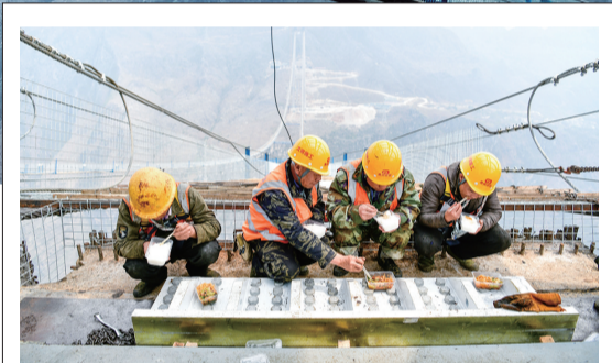
工人在花江峡谷大桥的桥塔上吃通过塔吊从地面送上来的午餐
