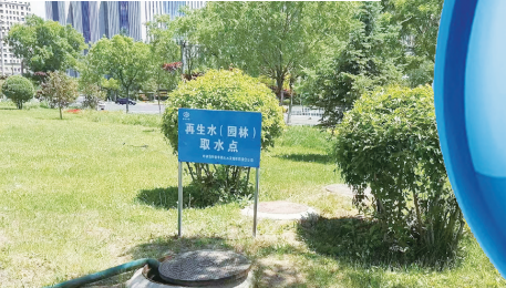
城市道路附近再生水取水点
